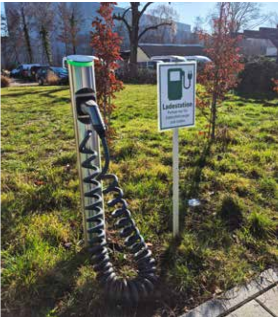
Eine der beiden E-Ladesäulen am Hohberghaus
